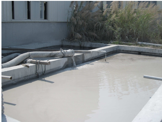
Wasserrwiederaufbereitungsanlagen sind in nahezu jeder Naturstein verarbeitenden Fabrik zu sehen.
