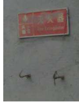
Die Feuerlöscher fehlen und sind im Brandfall nicht verfügbar.
